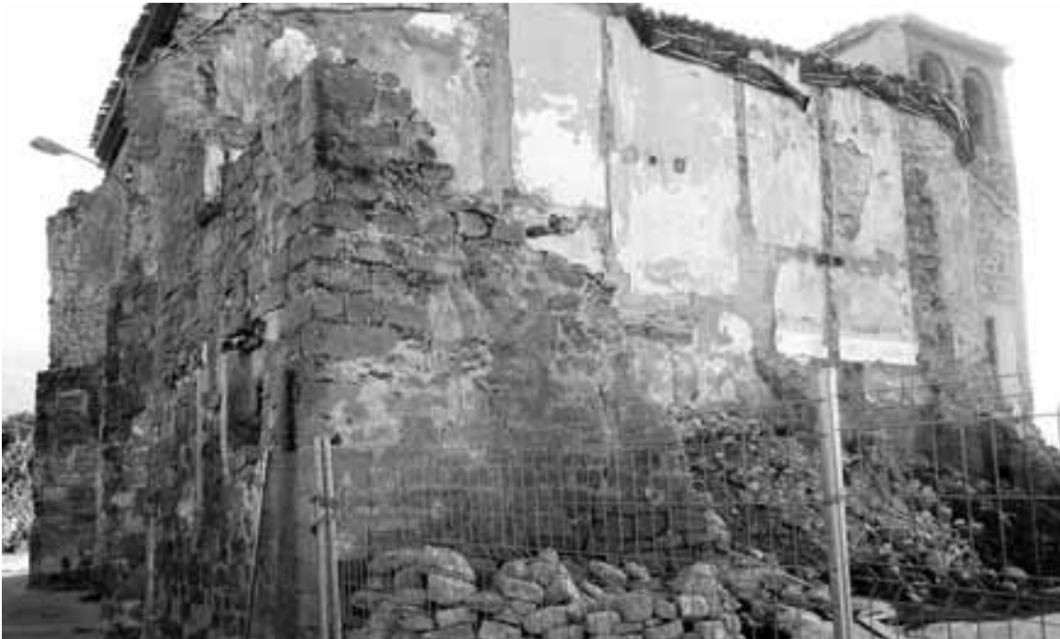
El aspecto de la iglesia de Labeaga es deplorable con los restos adosados del derribo. FOTO: M.G.V.
